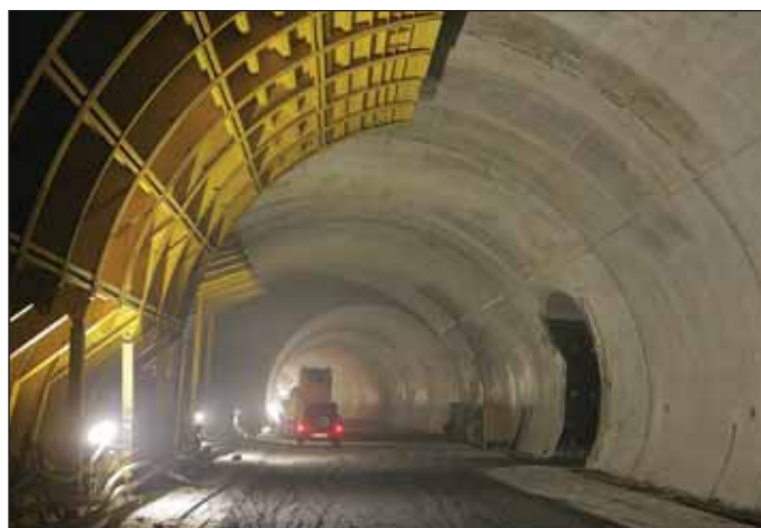
Obr. 1 Bednění sekundárního ostění zálivu Fig. 1 Formwork for secondary lining of the emergency parking bay
