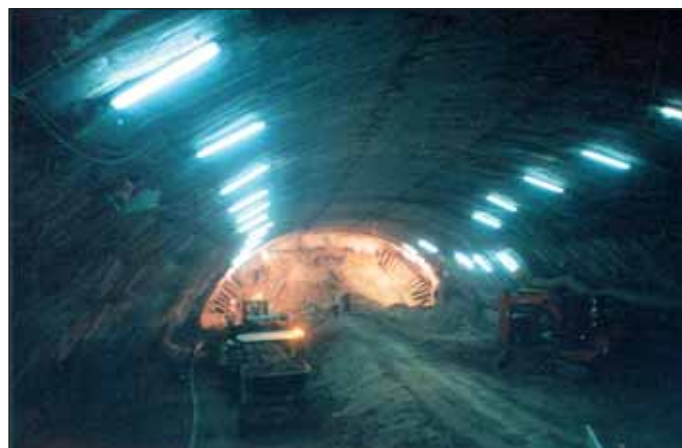
Obr. 4 Výstavba stanice Puerta del Sol – Gran Via – celkový pohled Fig. 4 Construction of Puerta del Sol-Gran Via station – overall view
