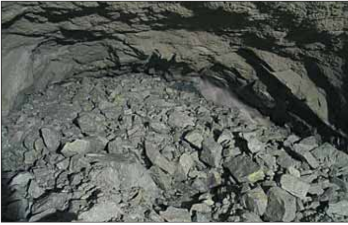
Obr. 5 Zával v úseku razenom technológiou NRTM v staničení 2900,0 m, na rozhraní blokov Z32 a Z33/1, po prívale podzemnej vody
