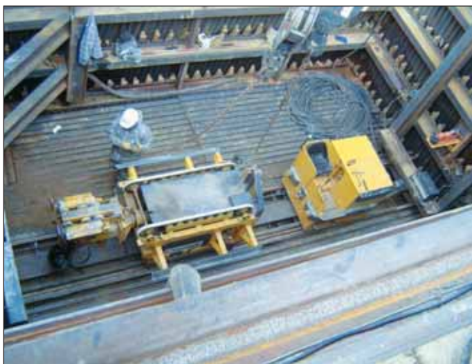
Obr. 4 Lokomotiva a speciální vozík pro přepravu železobetonových segmentů a jejich montáž ve štolě Fig. 4 The locomotive and RC segment transport and installation car
