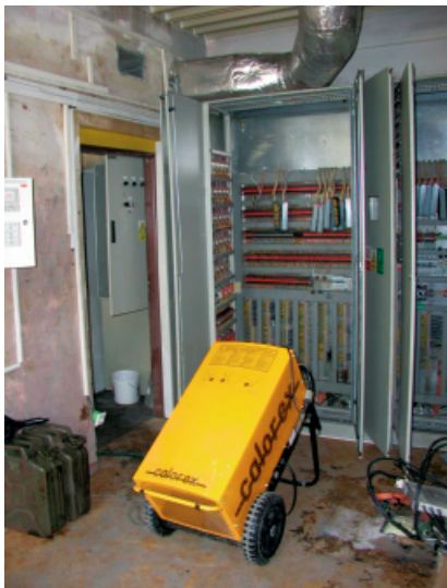
Obr. 4 Vysoušení prostor velínu po prvotní očiště Fig. 4 Drying the interior of the control centre after the initial clean-up
