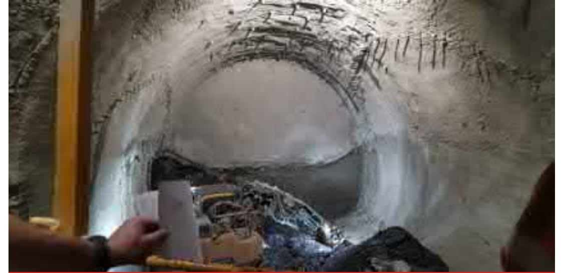
Dokončení ražby opěří a dna propojky sever do levého staničního tunelu vč. MKP deštníků 10/2022
