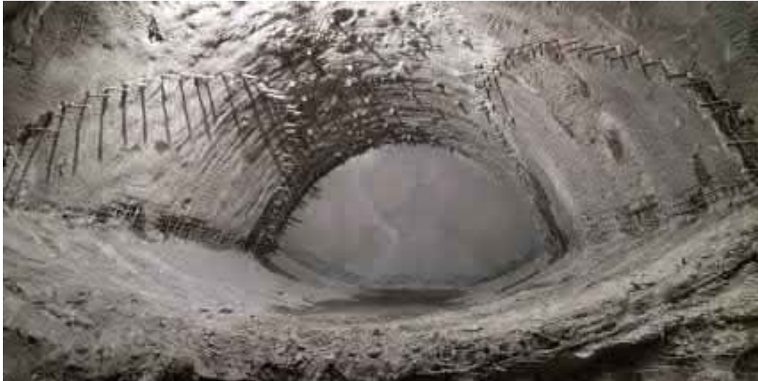
Dokončení ražby kaloty propojky sever do pravého staničního tunelu vč. MKP dešťníků 10/2022
