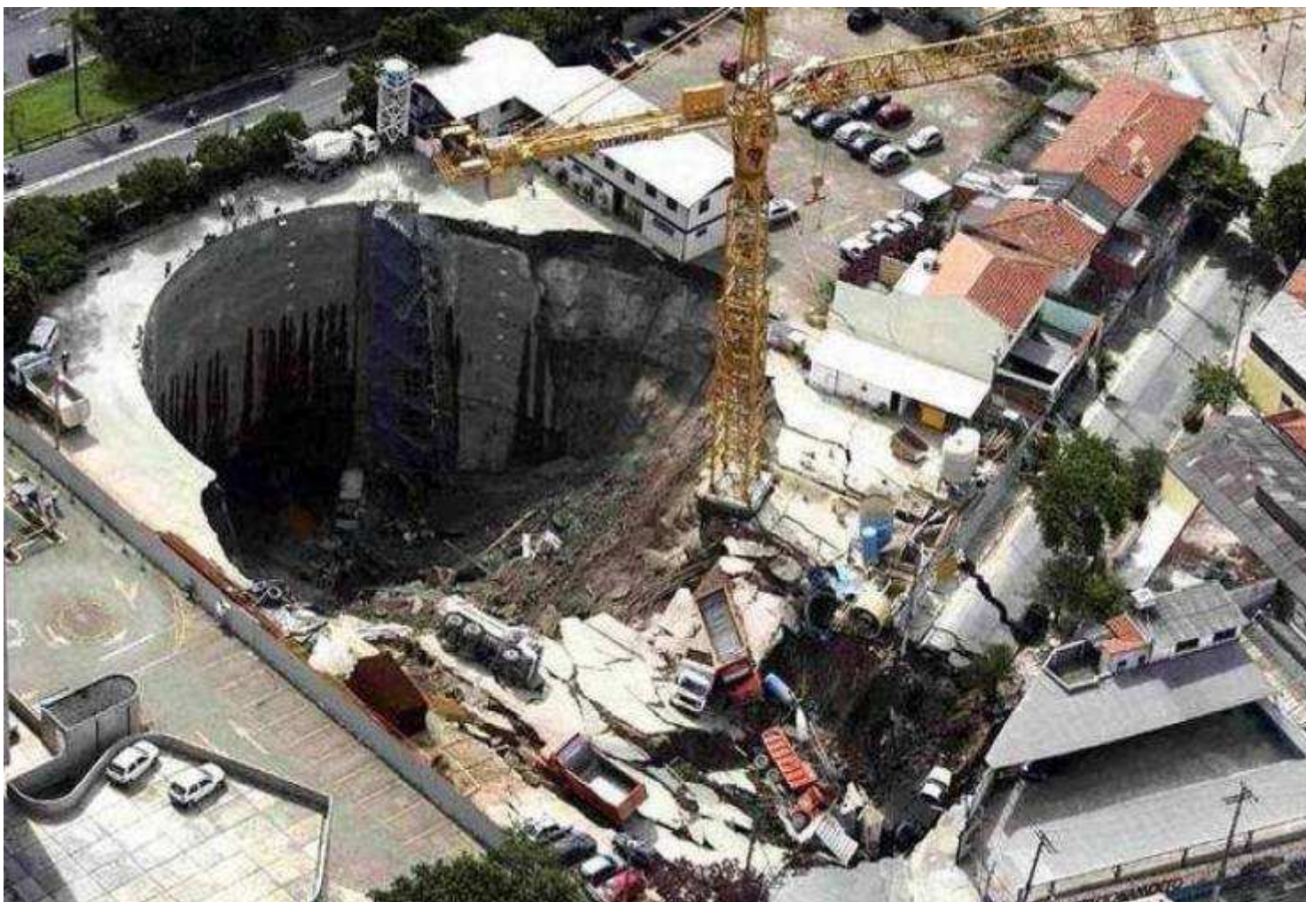
Rozsáhlé škody vzniklé následkem havárie stavební jámy v Sao Paulo -2007
