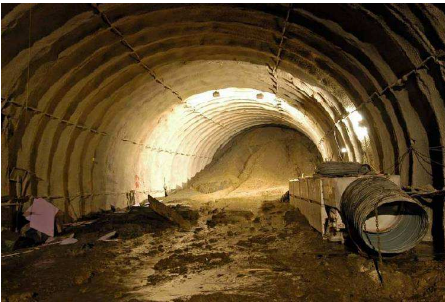
Pohled na místo havárie metra v Lausanne z vnitřního prostoru tunelové trouby-2005
