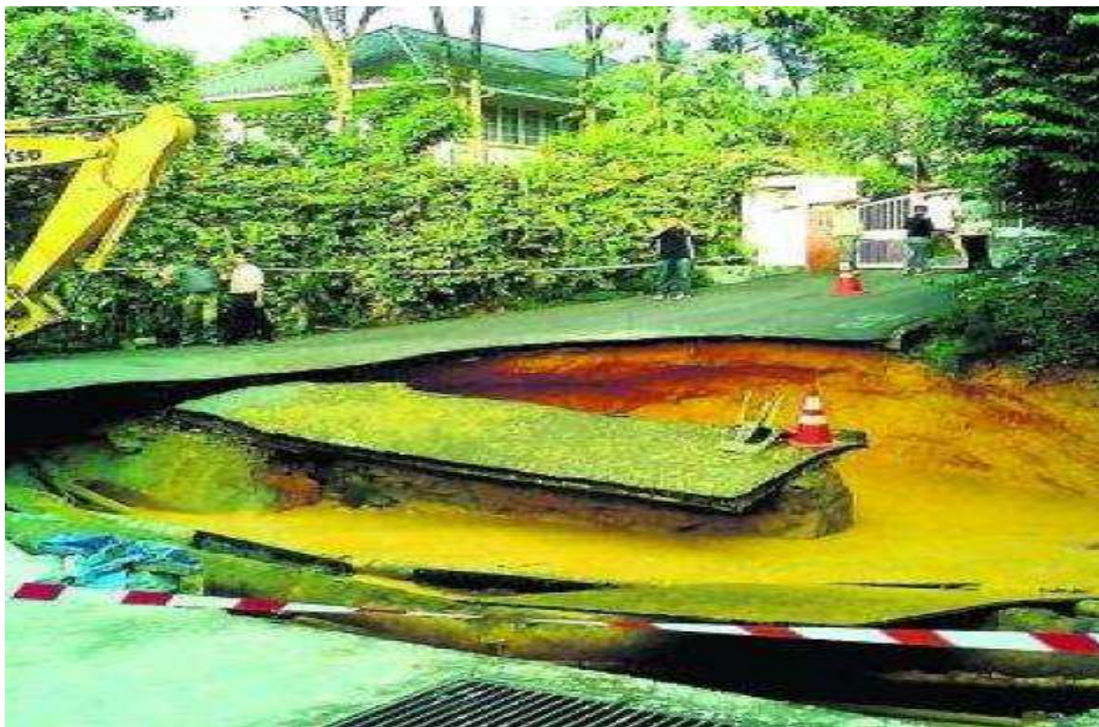
Silnice poškozená kráterem, vzniklým při havárii metra v Singapuru -2008
