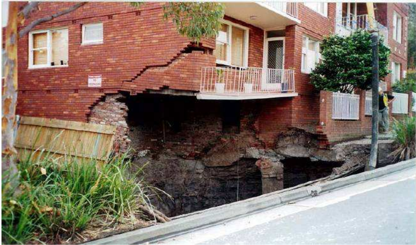
Budova poškodená následkom havárie tunelu Lane Cove –Sydney 2004
