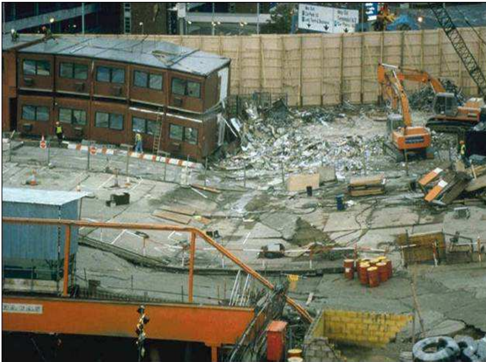
Propad terénu nad miestom havárie tunelu Heathrow
