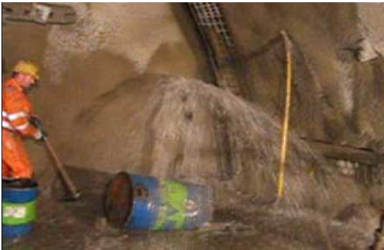
Průval podzemní vody v tunelu Wienerwald -2005
