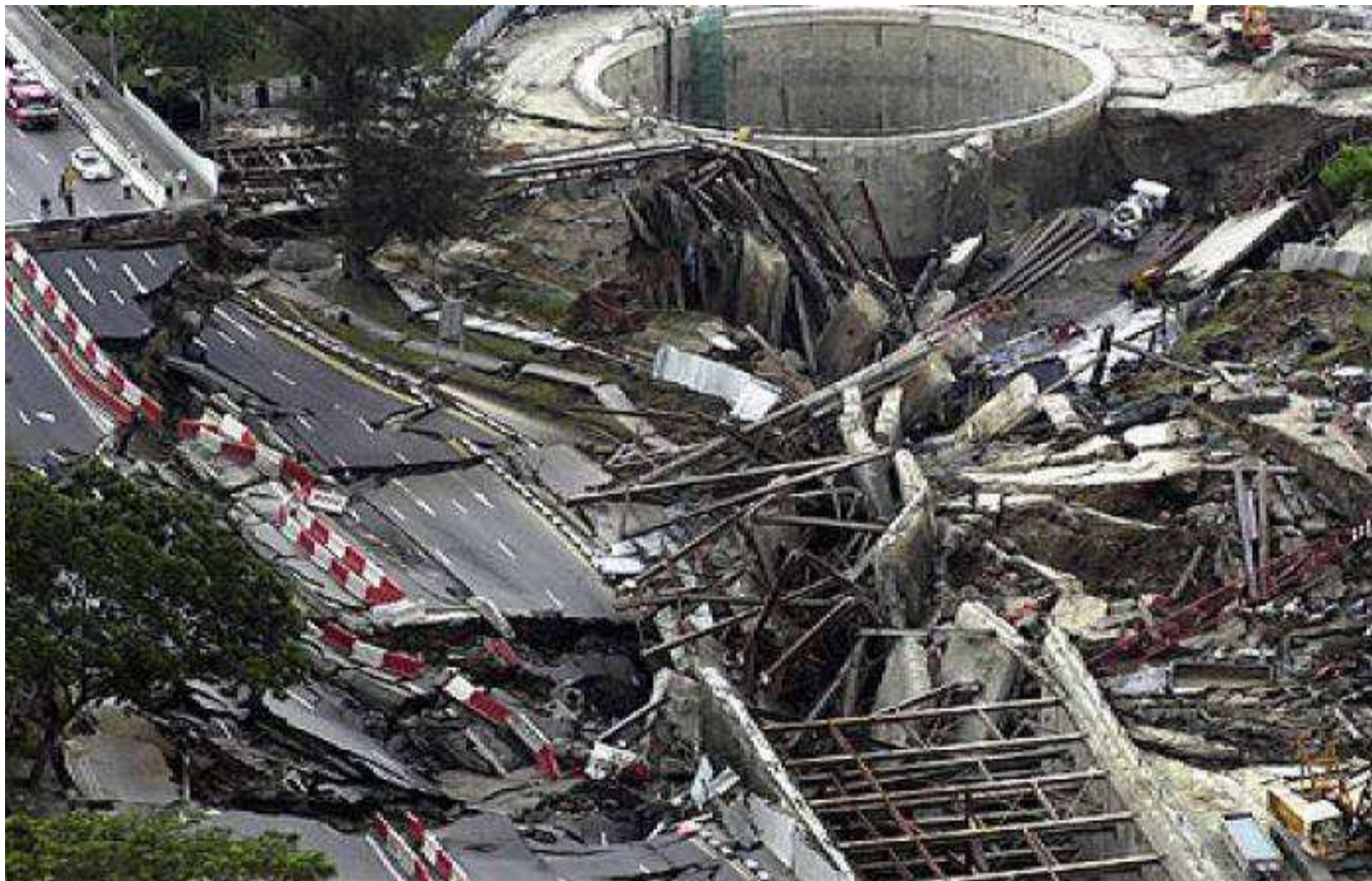
Havárie tunelu a jámy v Singapuru -2004
