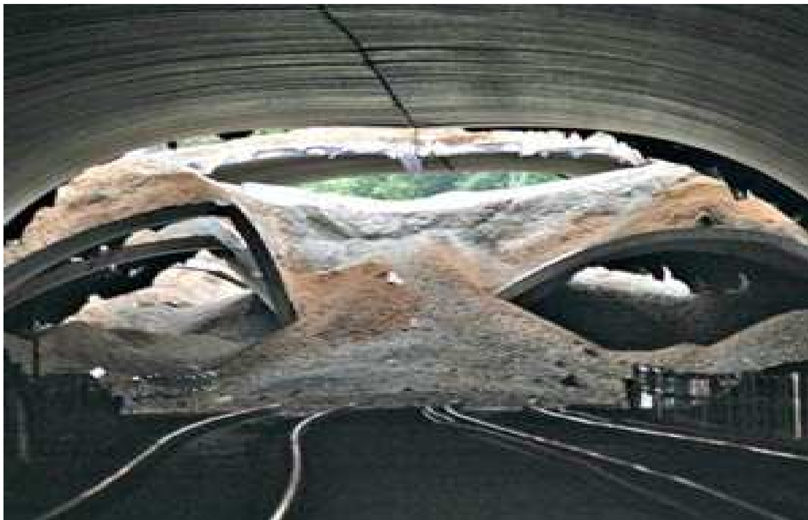
Kolaps několika segmentů ostění tunelu Tesco – Velká Británie 2005
